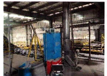
图 6 2#立式喷涂生产线固化炉
