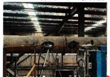
图 9 3#立式喷涂酸雾废气排放口
