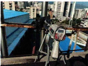
图 11 洗模中心碱雾排气筒 2#
